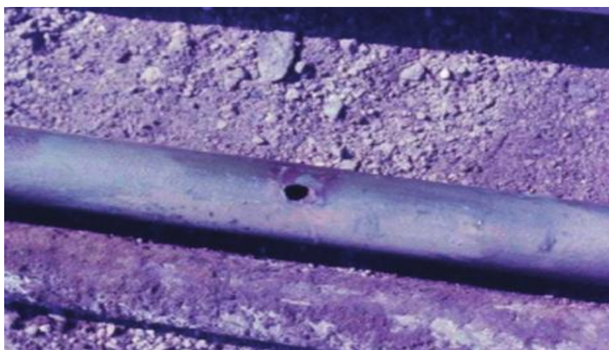
Figura 14 - Corrosão eletrolítica em tubos de aço provocada por corrente de fuga.
