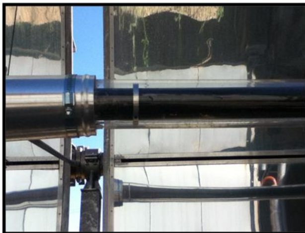
Figura 12 - Tubo absorvedor do concentrador solar instalado no CEFET-MG
